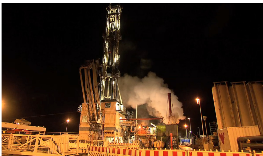
Kirchweidach: Erfolgreiche Bohrung bringt siedend heißes Wasser aus 3.500 Metern Tiefe an die Oberfläche
